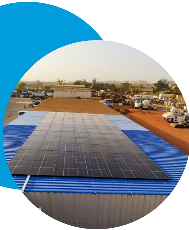
| Panneaux solaires installés à l'usine d'Eiffage Sénégal
