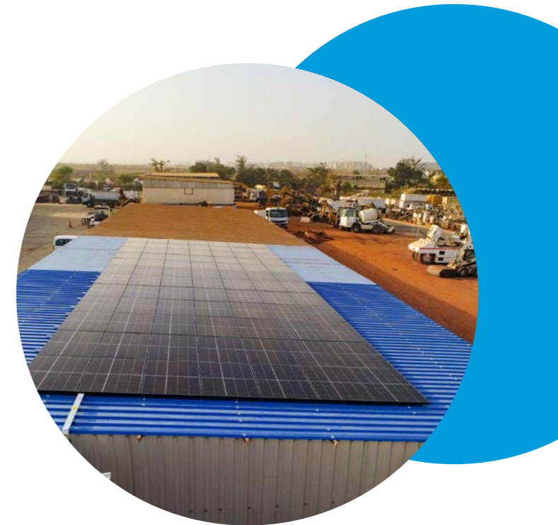
Солнечные панели, установленные в компании Eiffage Sénégal
